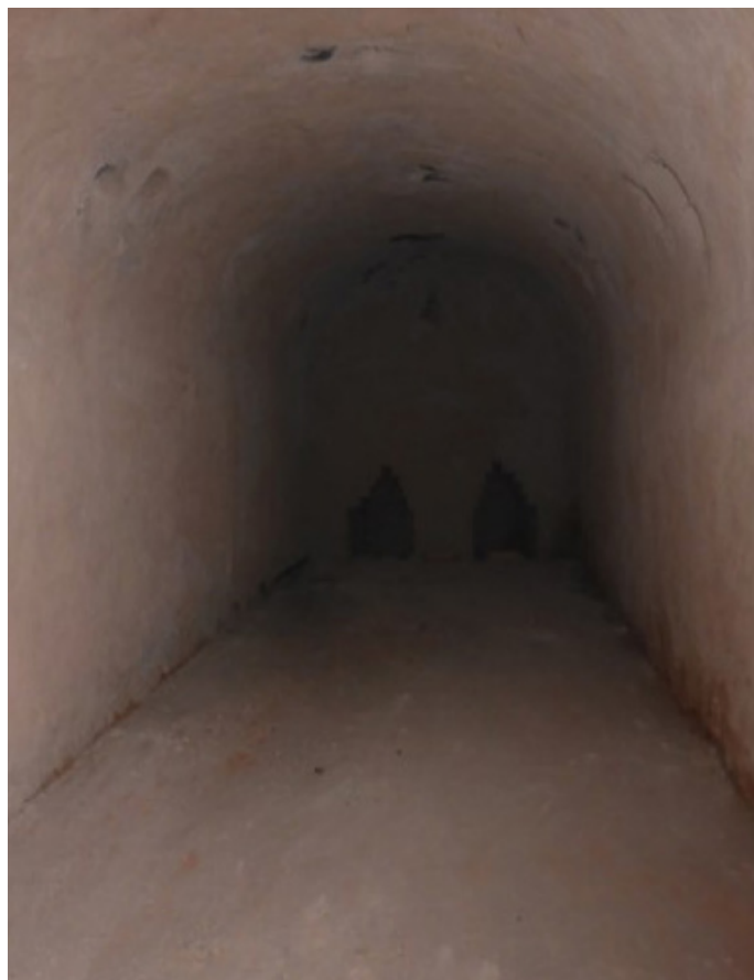
Le four après sa maintenance
