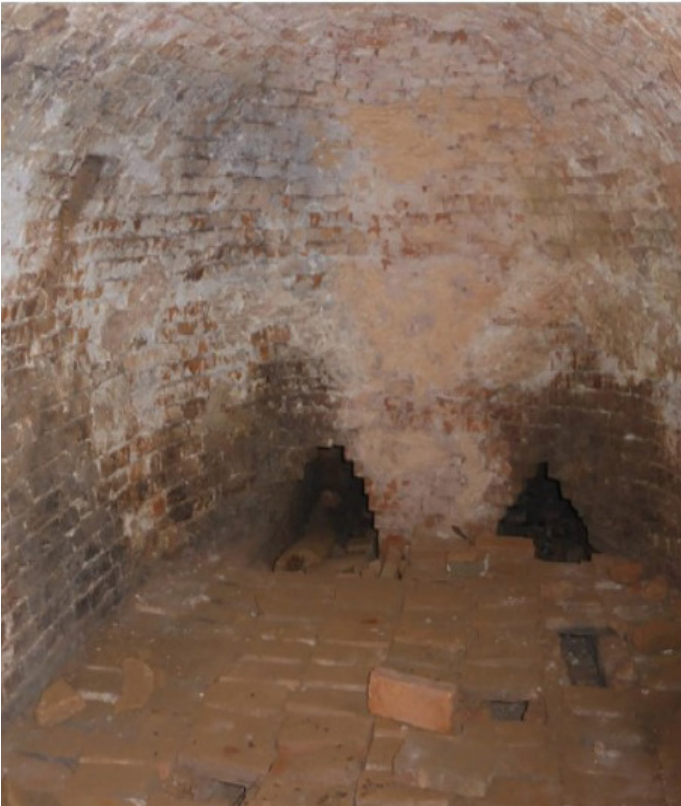
Le four avant sa maintenance
