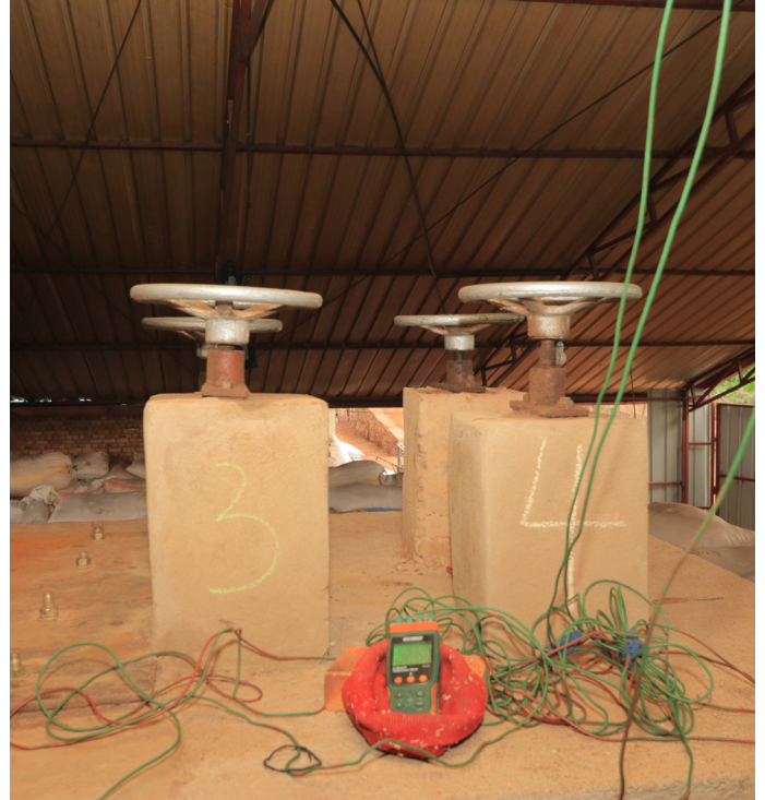
Vannes du four Zigzag
