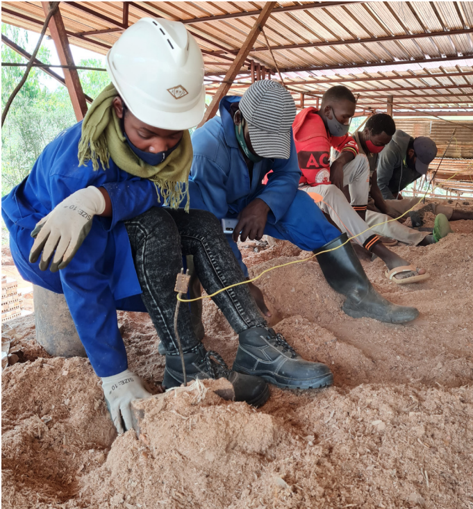
Alimentation par le haut du combustible du four
